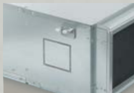
Подмес свежего воздуха, плenum под фильтр
